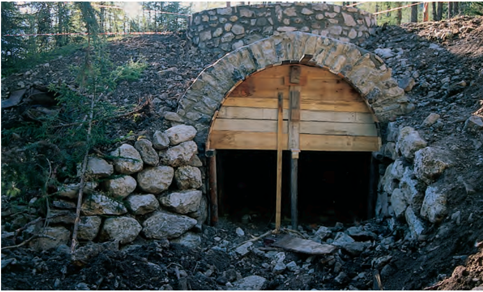
Mit einer umfassenden Gesamtanierung des Bestandes konnte der ursprüngliche Zustand des Ofens wiederhergestellt werden. Im Vordergrund sieht man das restrukturierte Gewölbe und dahinter erkennt man die heute branntüchtige zylinderförmige Ofenstruktur. (Aufnahme vom Verfasser)
